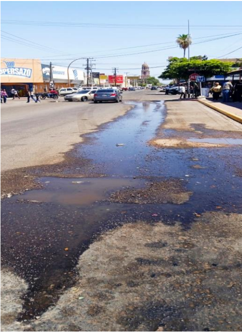
03/ 07/ 23 fuga de agua de drenaje del registro ubicado banqueta del mercado municipal García Morales
